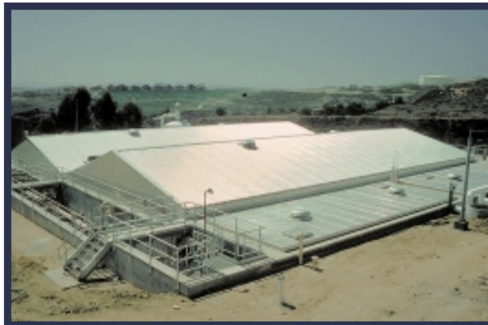
Rioolwaterzuivering, Trabuco, USA.
